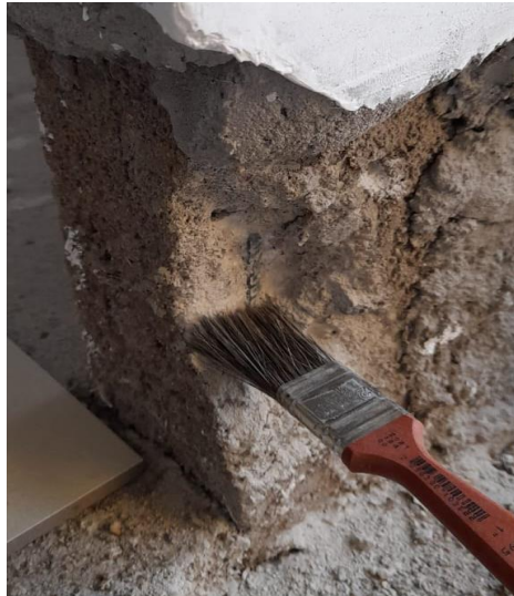
Figura 4: Exposição da armadura em um pilar de concreto armado para ensaio pelo Método I
