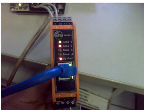
Figura 17 – Eletrônica sinalizando defeito para sala de controle Fonte: VALE, 2016
