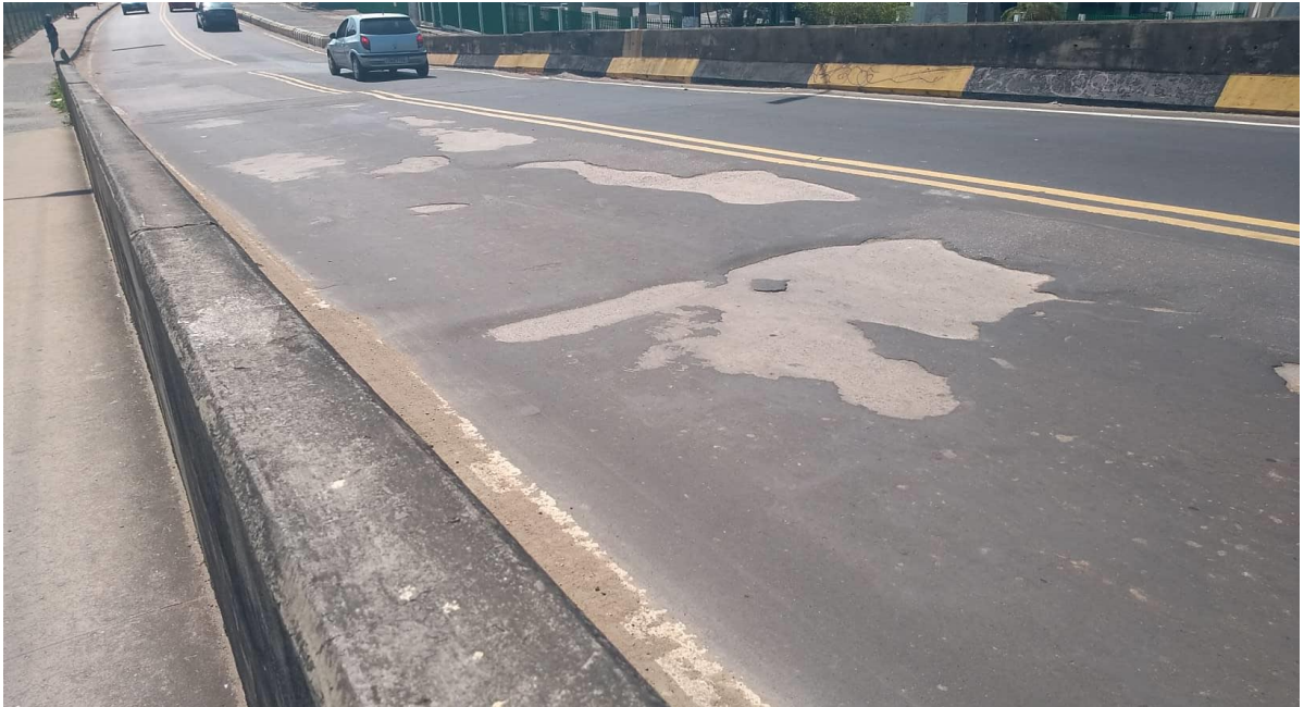
Figura 3: irregularidades na pista de rolamento. Fonte: acervo próprio.
