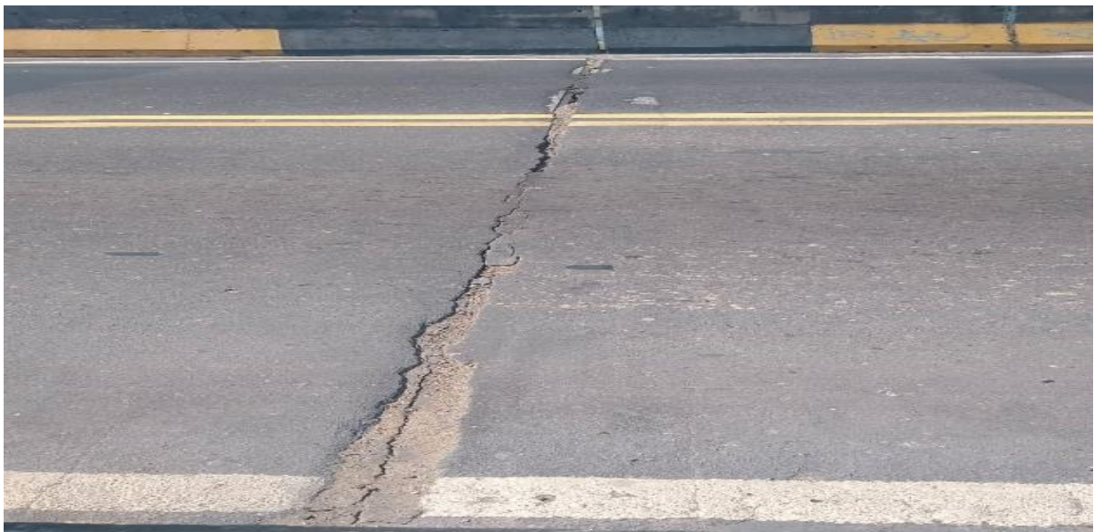
Figura 5: juntas de dilatação com desgaste e ineficácia. Fonte: acervo próprio.
