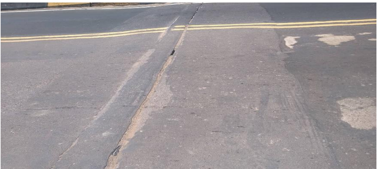
Figura 4: desnivelamento no encontro das placas. Fonte: acervo próprio.
