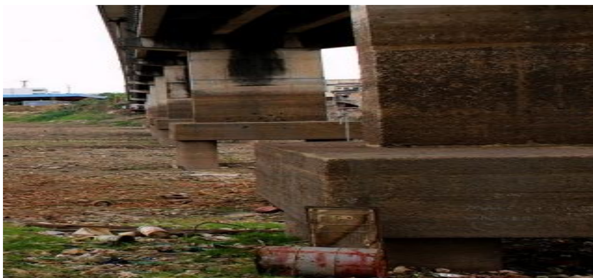
Figura 8: fissuras em pilar. Fonte: acervo próprio.
