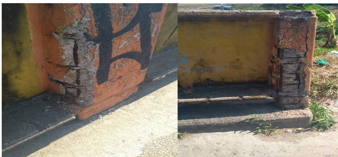
Figura 7: guarda corpo com armadura exposta. Fonte: acervo próprio.
