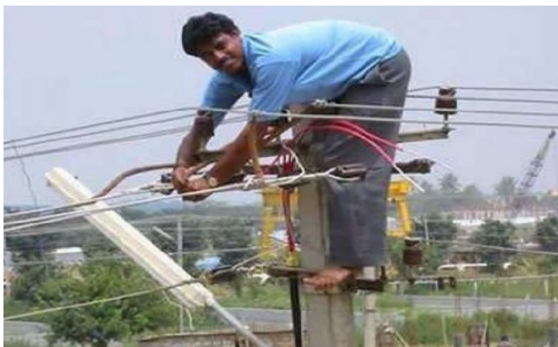
Figura 1. Atos inseguros distribuição de energia
