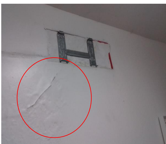
Figura 2 – Fissura na parede dos apartamentos. Autor, 2018.
