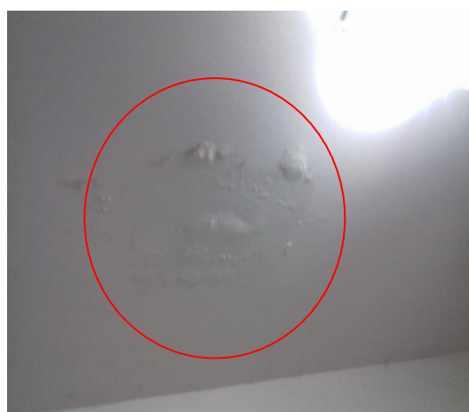
Figura 3 – Bolhas no teto dos apartamentos. Fonte O Autor, 2018.
