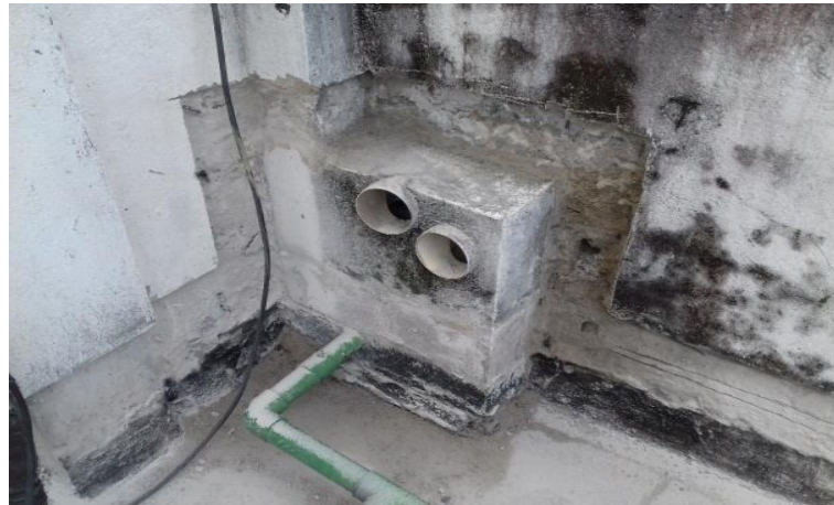
Figura 6 – Falta de impermeabilização nos ralos. Fonte. Autor, 2018.
