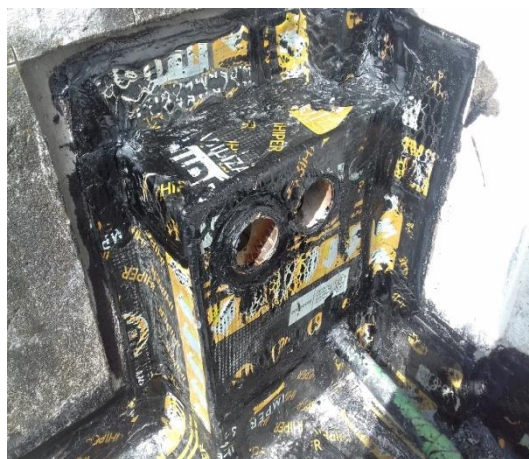
Figura 14. Imperbeabilização dos ralos.Fonte. Autor, 2018.
