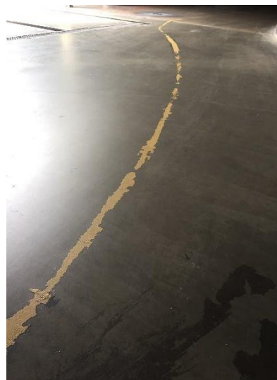
Figura 3: Descascamento da pintura de sinalização horizontal Fonte: Próprio Autor
