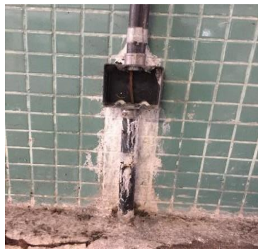
Figura 12: Fiação exposta Fonte: Próprio Autor
