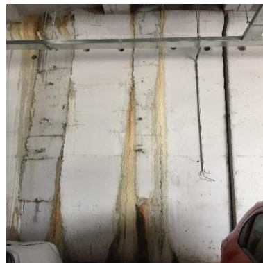
Figura 13: Eflorescência Fonte: Próprio Autor
