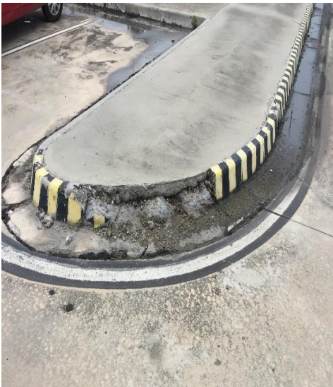
Figura 6: Sarjeta quebrada Fonte: Próprio Autor
