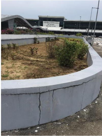
Figura 4: Fissura na jardineira Fonte: Próprio Autor
