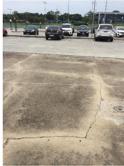
Figura 5: Fissura no piso Fonte: Próprio Auto
