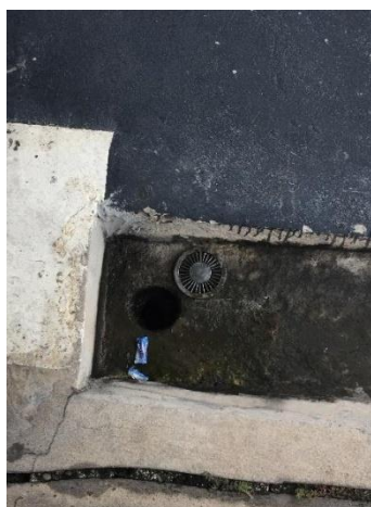
Figura 11: Ralo entupidos e/ou sem tampa Fonte: Próprio Autor
