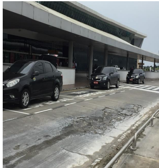
Figura 7: Pavimento danificado no viaduto Fonte: Próprio Autor
