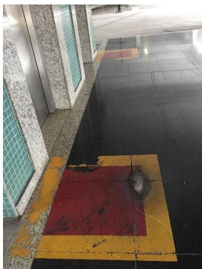
Figura 2: Descascamento da pintura em frente ao elevador desembarque Fonte: Próprio Autor
