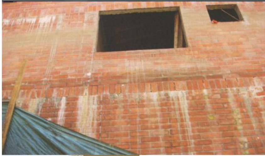
Figura 5: Eflorescência abundante por supersaturação de umidade de obra [38].
