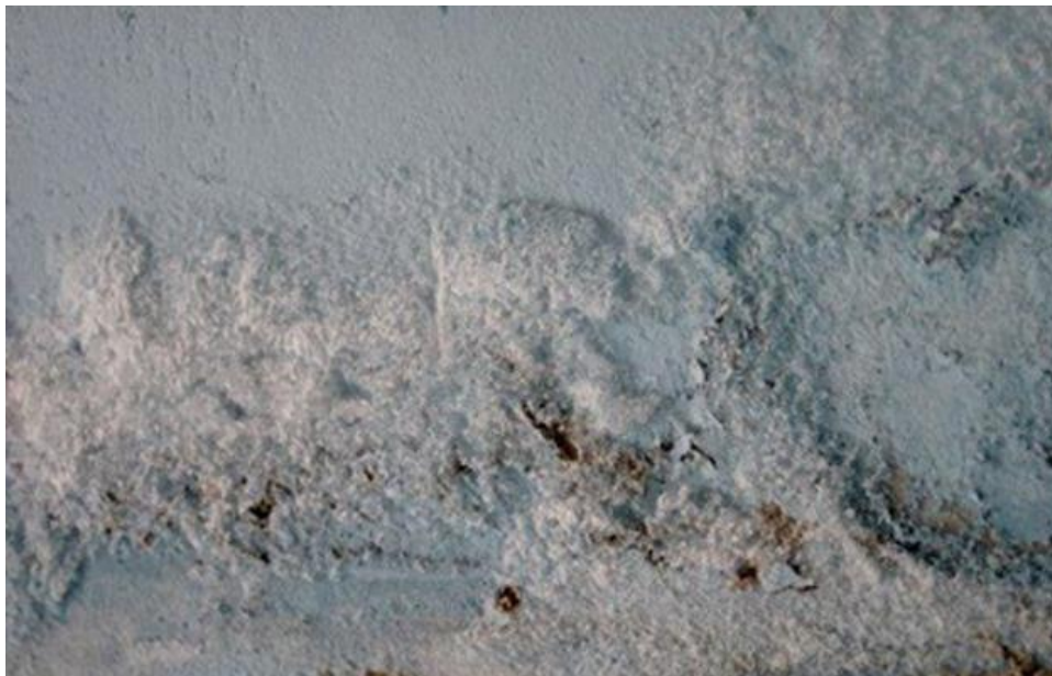
Figura 6: Parede com saponificação na alvenaria [20].
