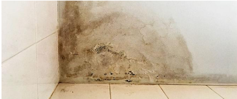
Figura 7: Umidade Ascendente com manchas escuras e degradação de pinturas [46].
