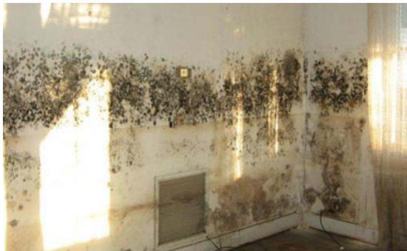
Figura 9: Parede com manchas de bolor [14].
