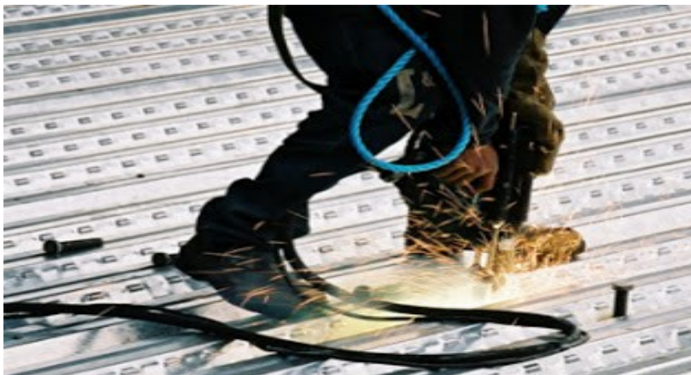
Figura 2: Soldagem em stud bolt das chapas na implantação da laje. Fonte: Mundo Concreto, 2013.
