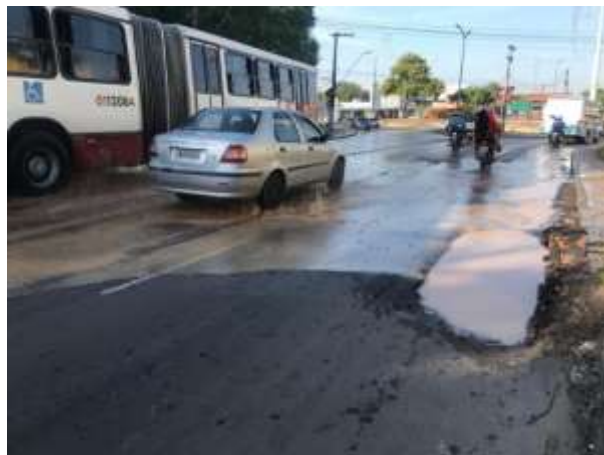
Figura 13 - Avenida Camapuã, no dia do rompimento da tubulação. Foto: Patrick Marques/G1 AM
