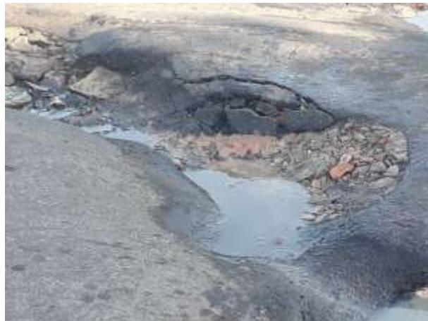
Figura 6 – Exemplo de Fendas. Localizado na Rua Ipixuna, Manaus. Fonte: Acervo próprio.
