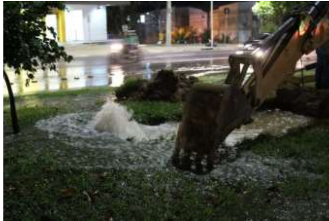
Figura 10 - Rompimento de tubulação no canteiro central. Foto: Rickardo Marques/G1
