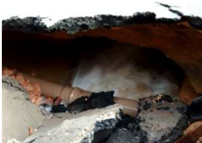
Figura 8 - Vazamento em tubulação de água, na avenida silves. Fonte: Amazonas noticias
