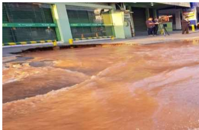
Figura 15 - Com o rompimento, a avenida ficou alagada nesse trecho. Foto: Meike Farias/Rede Amazônica
