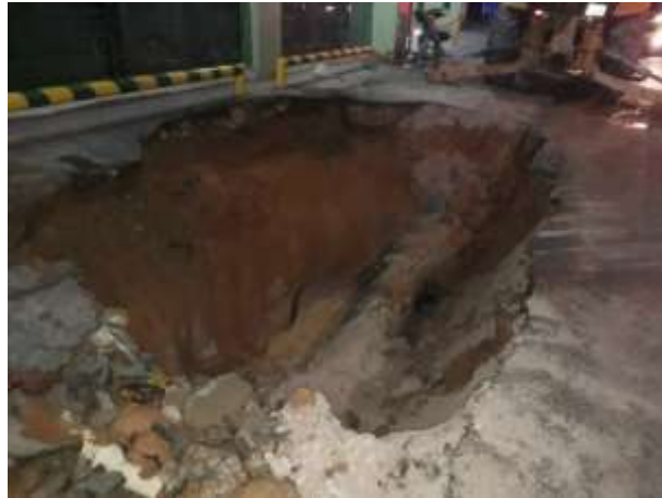
Figura 16 - Cratera aberta pelo rompimento na calçada e no pavimento. Foto: Acervo próprio
