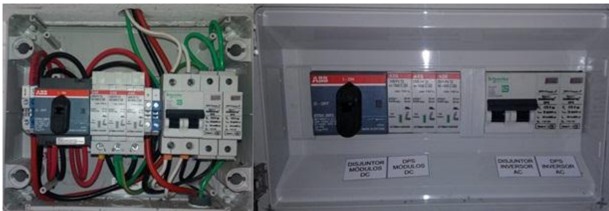
Figura 5 – Vista interna e externa do quadro de proteção
