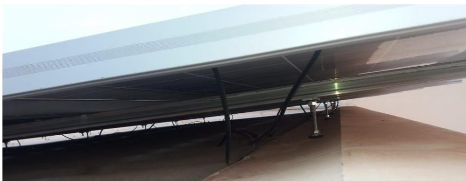
Figura 2 – Vista lateral das séries fotovoltaicas
