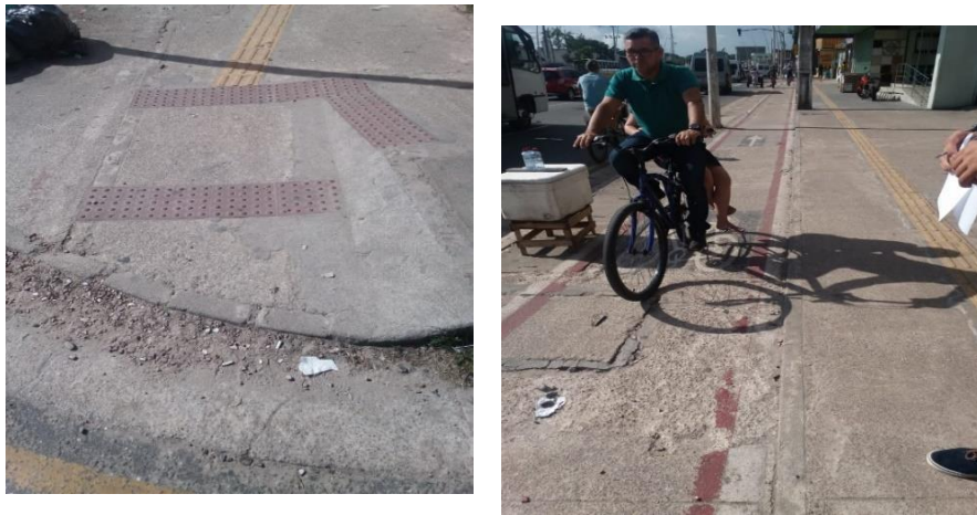
Figura 06 e 07: Condições de acessibilidade na Avenida Augusto Montenegro.
