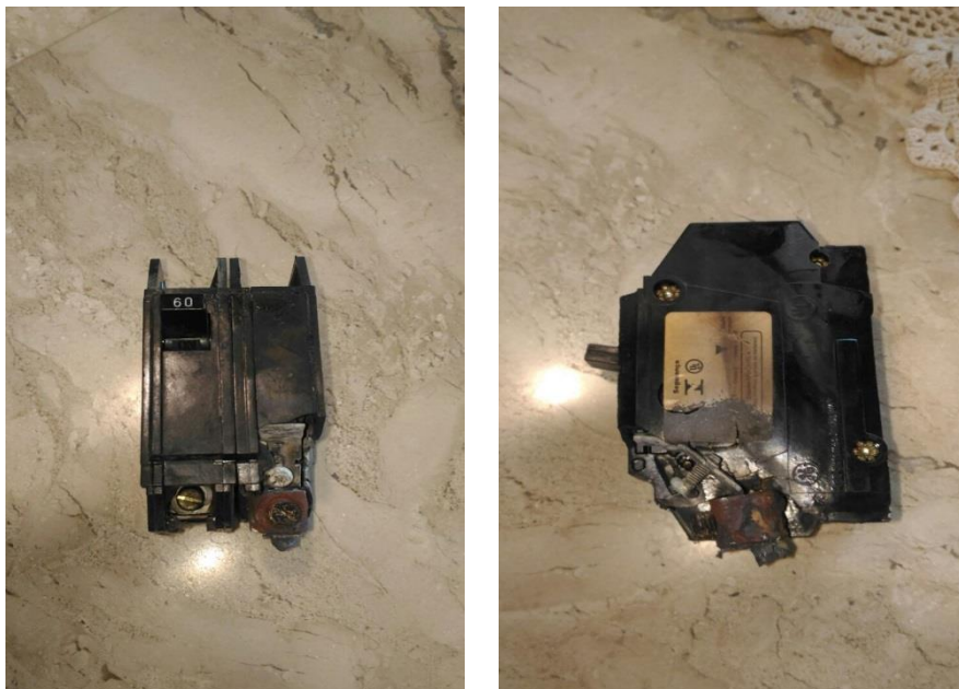
Fig 5: Disjuntor danificado por sobrecorrente Fonte: Proprio autor.
