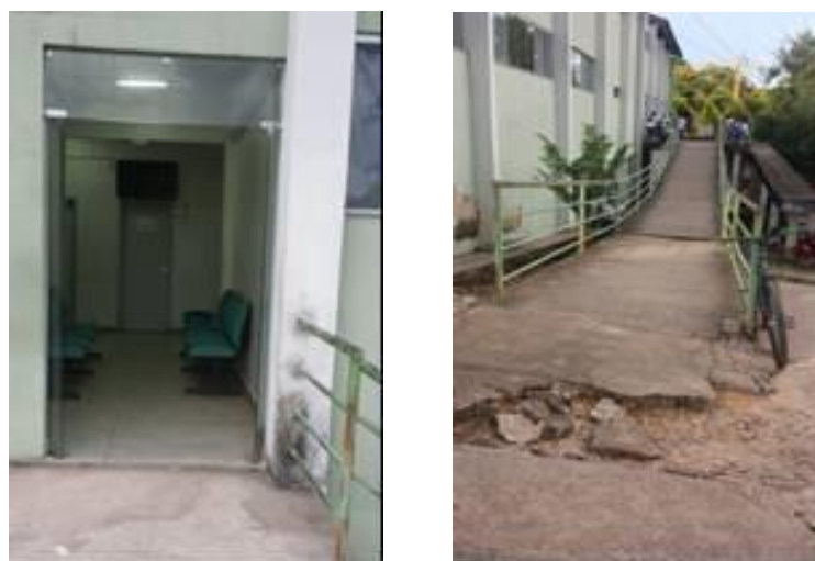
Figura 16 e 17 – Desníveis no piso e no corredor.
