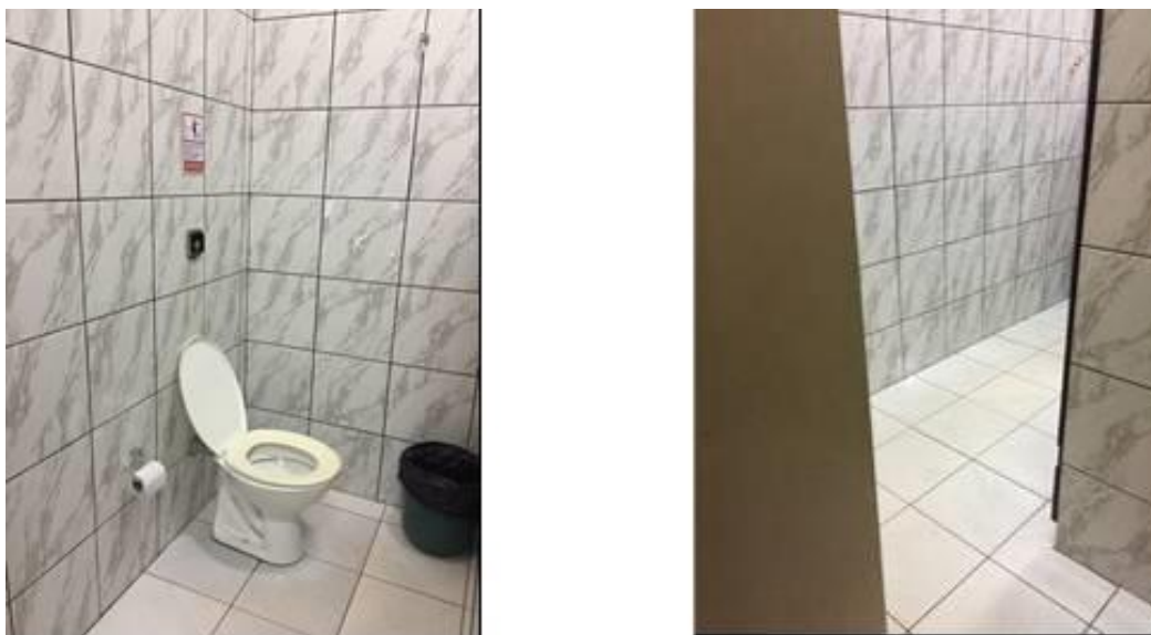
Figura 10 e 11 – Lavatório do LEC
