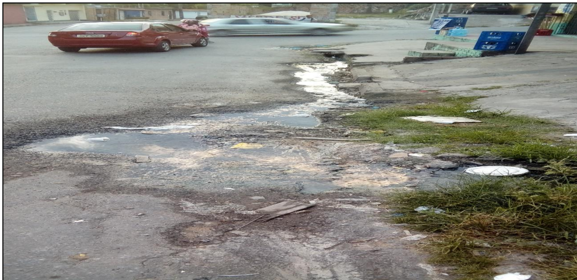
Figura 4: Ausência de sarjeta e aparecimento de vegetação. Fonte: Acervo próprio, 2018.
