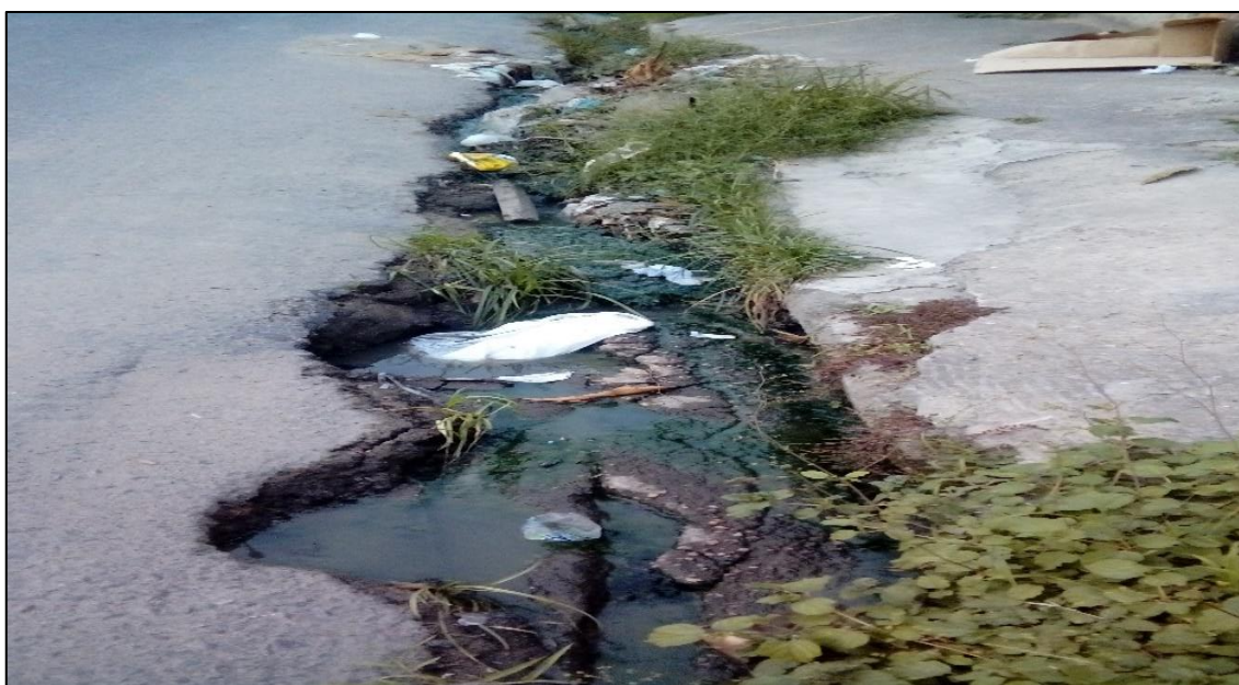
Figura 5: Sarjeta com erosão e aparecimento de vegetação. Fonte: Acervo próprio, 2018.
