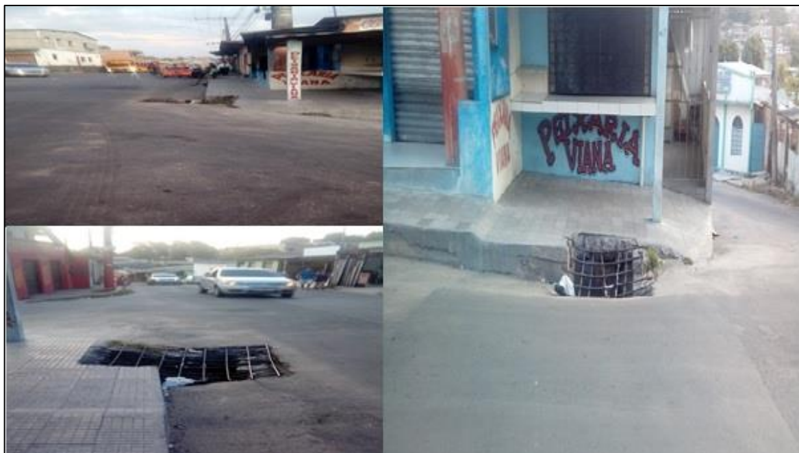
Figura 3: Tampa de boca de lobo somente com armadura de aço exposta. Fonte: Acervo próprio, 2018.
