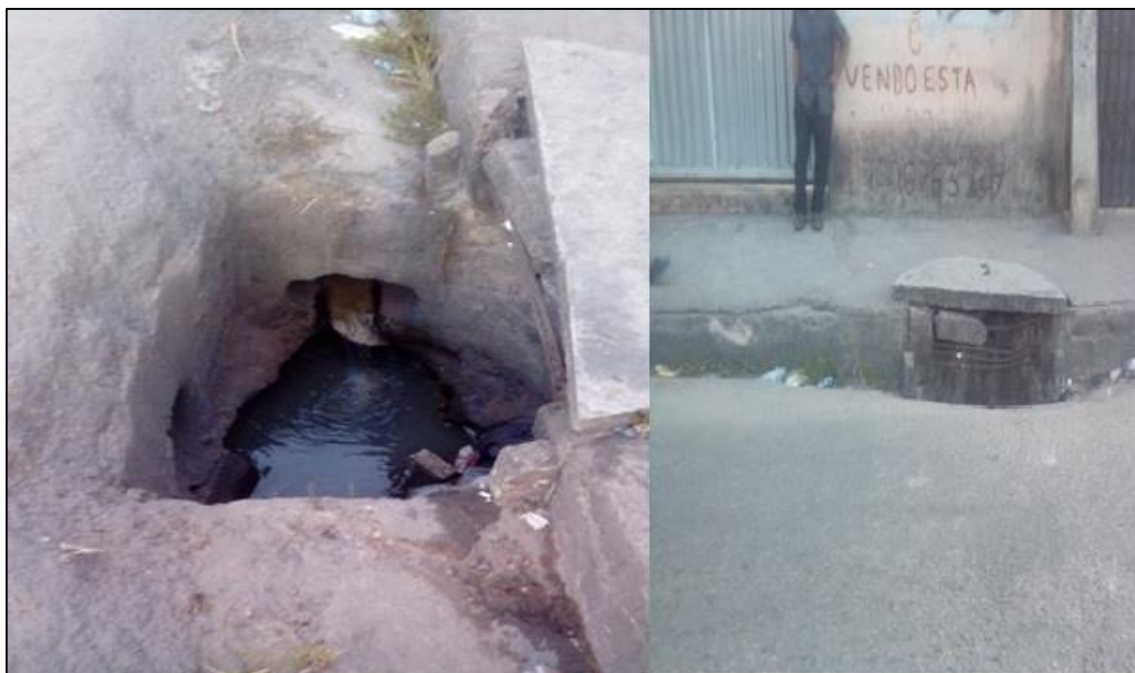
Figura 2: Boca de lobo sem tampa, com tubo de galeria danificada e fundação erodida. Fonte: Acervo próprio, 2018.
