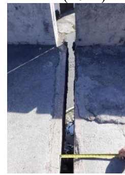
Figura 25b: Junta de dilatação - km 14,15 Pista Sentido São Pedro da Aldeia - Cabo Frio (2021)
