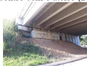
Figura 28b: Infiltração nos apoios do encontro com o aterro (2021)
