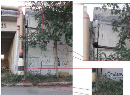
Figura 35a: Deslocamento da placa de concreto (2019)
