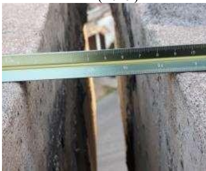
Figura 25a: Junta de dilatação - km 14,15 Pista Sentido São Pedro da Aldeia - Cabo Frio(2019)
