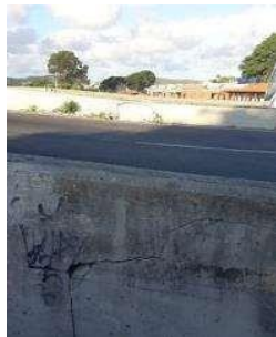
Figura 32a: Trinca barreira(2019)
