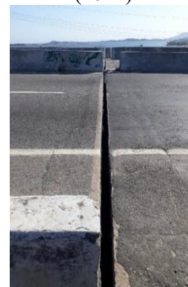
Figura 24b: Juntas de dilatação - km 14,15 (2021)
