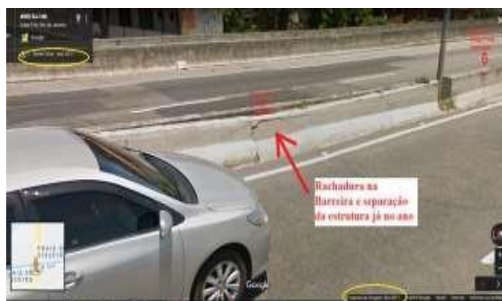
Figura 40: Trinca na barreira do Canal Palmer – 2017
