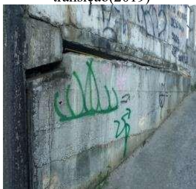
Figura 31a:Deslocamento da laje de transição(2019)
