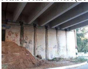
Figura 28a: Infiltração nos apoios do encontro com o aterro(2019)
