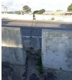
Figura 27a: Junta de dilatação - km 14,15 Pista Sentido Cabo Frio – São Pedro da Aldeia(2019)
