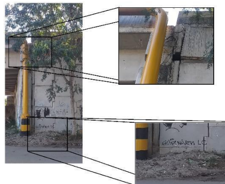
Figura 35b: Deslocamento da placa de concreto (2021)
