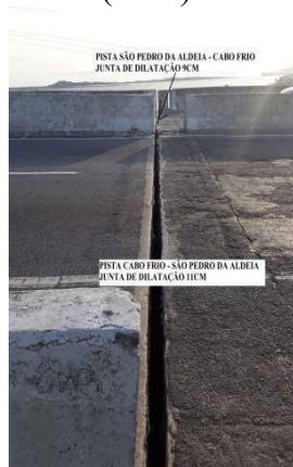
Figura 24a: Juntas de dilatação - km 14,15 (2019)
