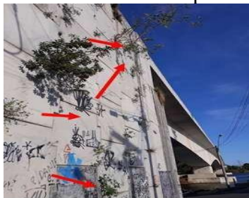
Figura 21a: Vista lateral esquerda km 14,1 – encontro do aterro com a ponte (2019)
