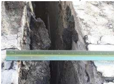
Figura 26a: Junta de dilatação - km 14,15 Pista Sentido Cabo Frio – São Pedro da Aldeia(2019)
