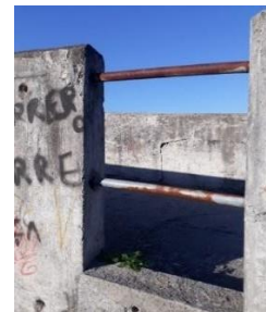
Figura 32b: Trinca barreira(2021)
