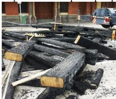
Figura 6: Seção transversal após exposição ao fogo
