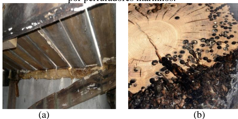
Figura 2. a) Madeira danificada por fungos, bactéria e cupins ; b) Madeira degradada por perfuradores marinhos.
