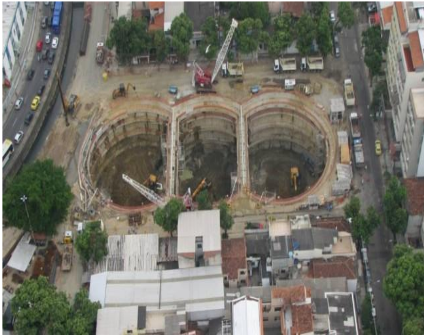
Figura 4 Vista da obra do reservatório triplo na Praça Niterói Fonte: Jornal EXTRA / O Globo.
