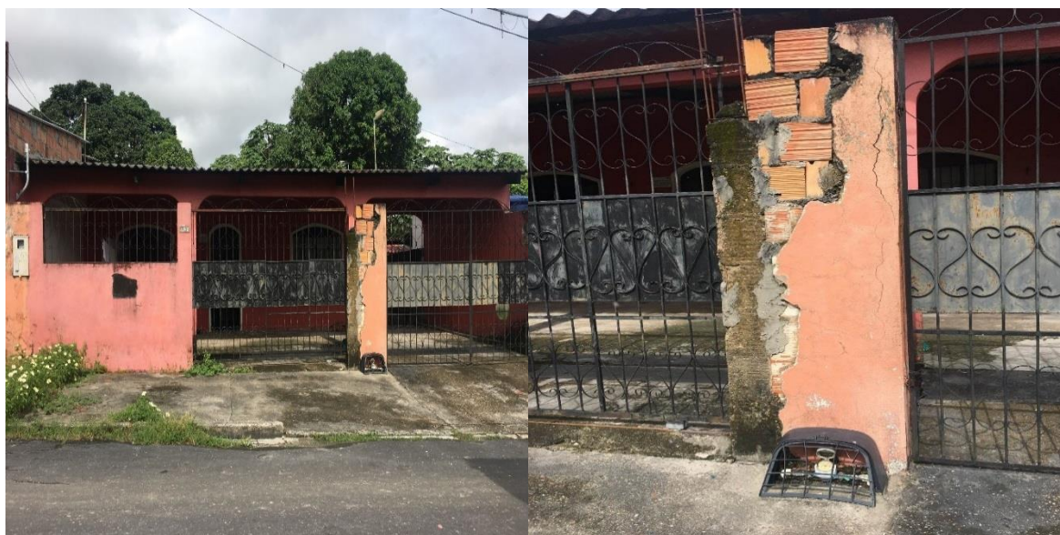
Figura 2: Apresenta fissuras e a sua estética comprometida. Fonte: Autor,2018
