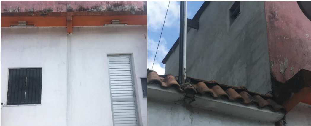
Figura 3: Edificação 1, Manchas e fissuras, Fonte: Autor.2018.
