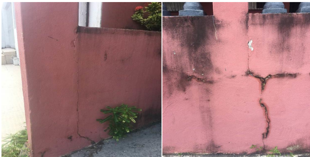
Figura 5: fissuras visíveis na fachada, e estética do revestimento prejudicada.
