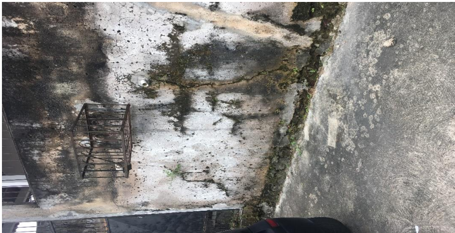
Figura 4: Parede com manchas, bolor e fissuras – Fonte: Autor,2018
