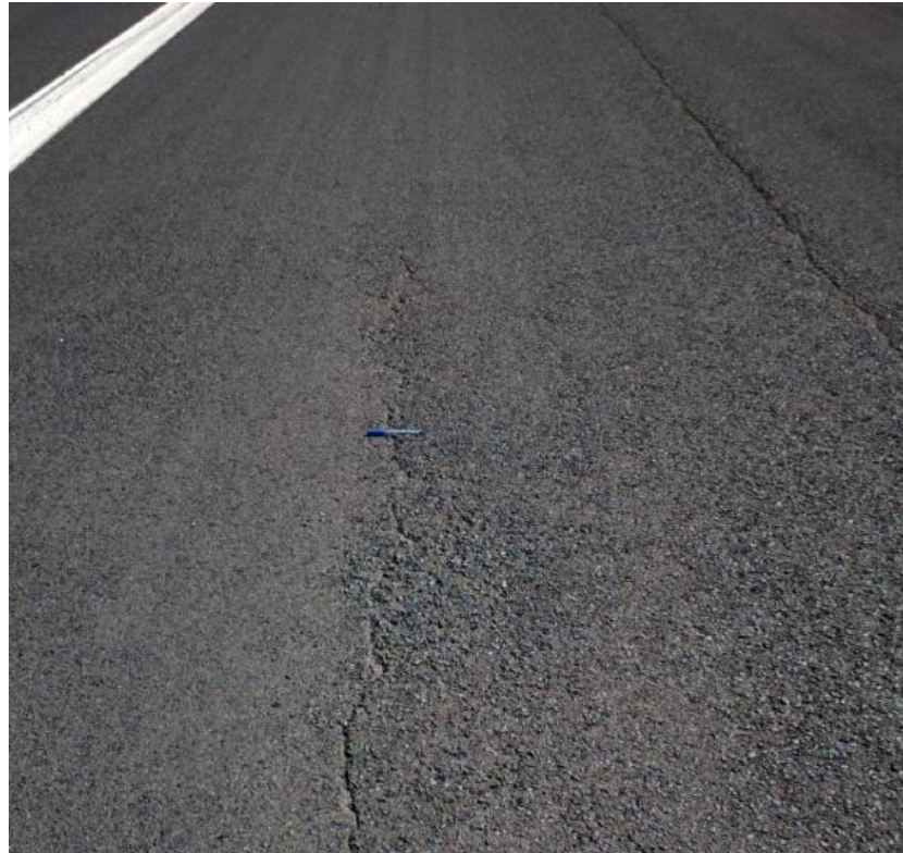
Figura 6. Defeito ASTM nº8 B e ASTM nº8 M respectivamente (pista de pouso e decolagem)
