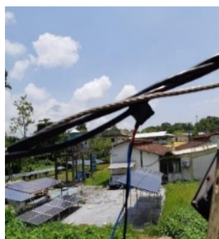
(e) Visão aérea da conexão dos cabos de alimentação do QCF-13 na MR.
