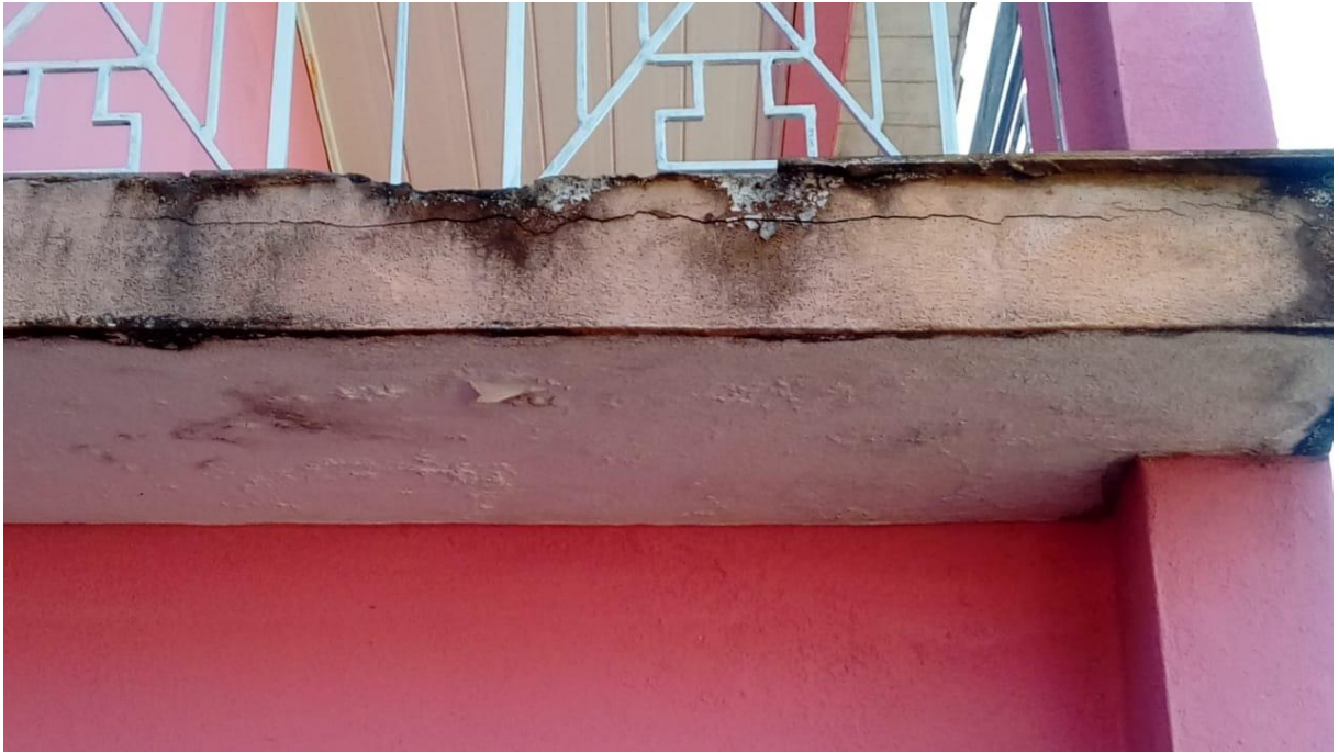
Figura 3: Apresentação de fissura e manchas na laje. Fonte: próprio autor.
