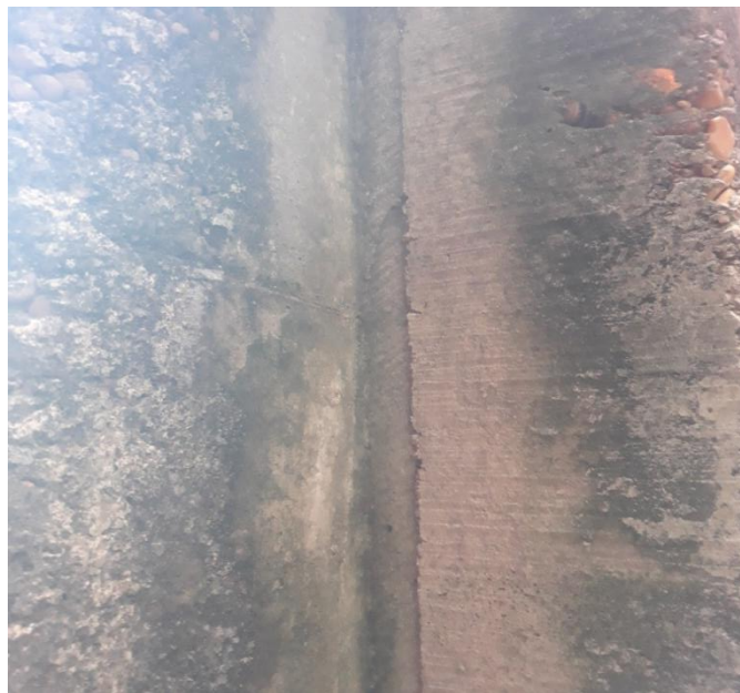
Figura 6: Manchas esverdeadas no pilar. Fonte: próprio autor.
