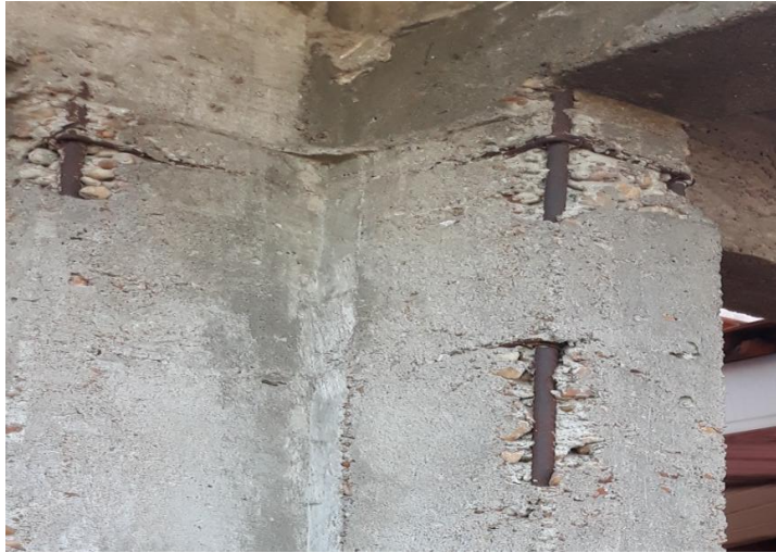
Figura 5: Exposição de armadura no pilar. Fonte: próprio autor.
