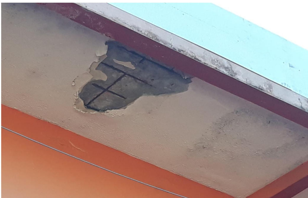
Figura 2: Exposição das armaduras. Fonte: próprio autor.
