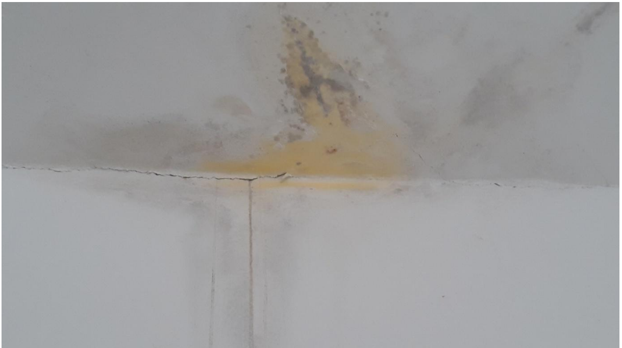
Figura 4: Eflorescência na laje interna. Fonte: próprio autor.
