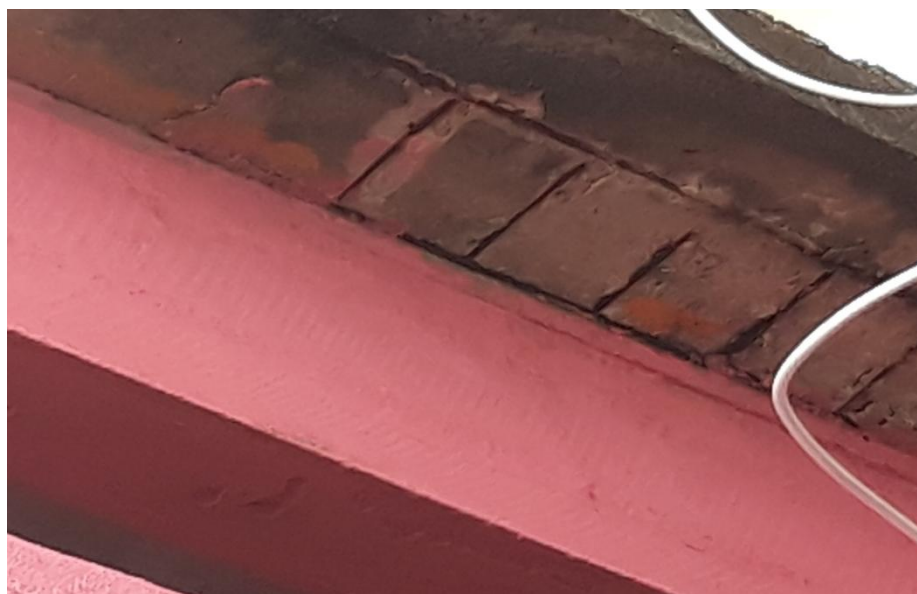
Figura 1: Exposição das armaduras. Fonte: próprio autor.
