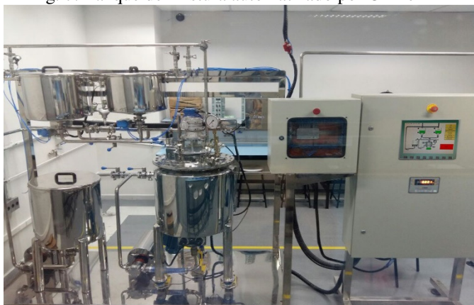
Fig. 7. Tanque de Mistura automatizado por CLP e IHM
