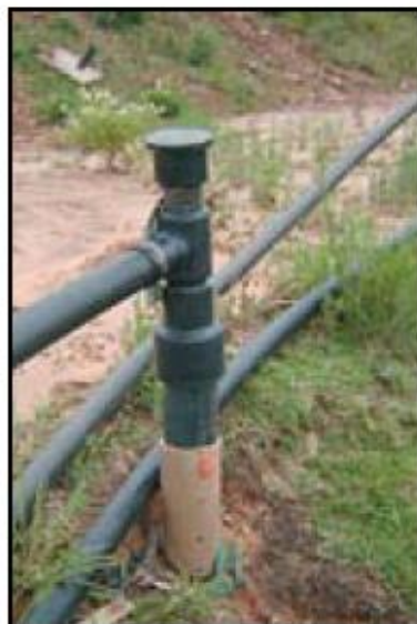
Figura 9: Cabeçote de adaptação de dreno existente. Fonte: CENBIO (2009).
