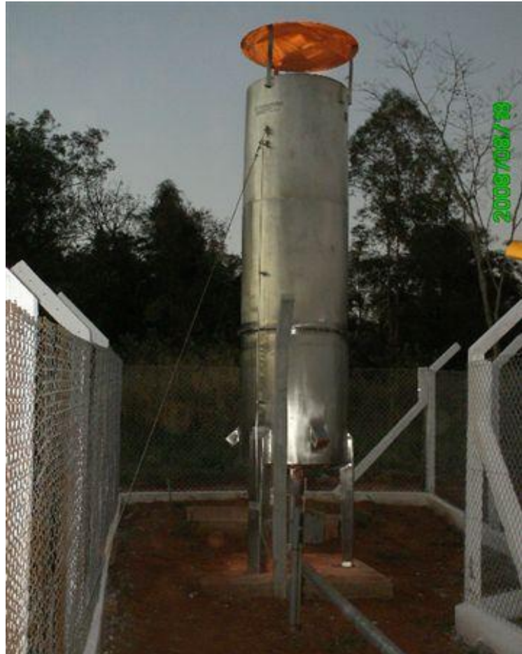
Figura 10: Flare eclausurado. Fonte: Combustec Queimadores (2013).
