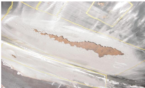
Figura 11: Área delimitada da cavitação
