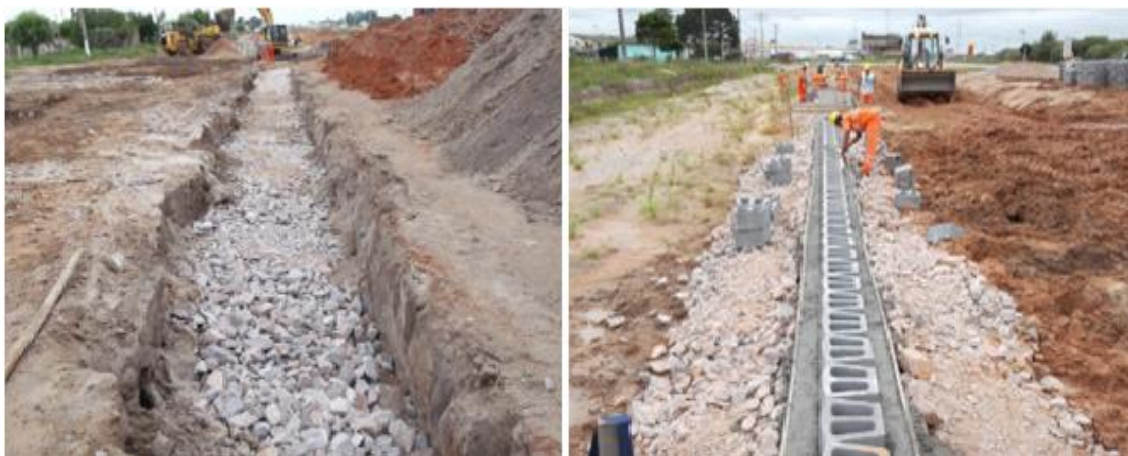
Figura 9- Execução de vala com rachão para apoio da base da soleira. Fonte: Autor, 2015.
