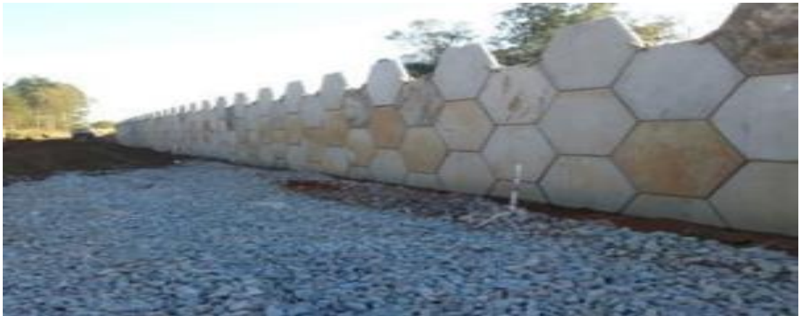
Figura 2- Face amento do muro com inclusão de malhas de aço. Fonte: Autor, 2015.
