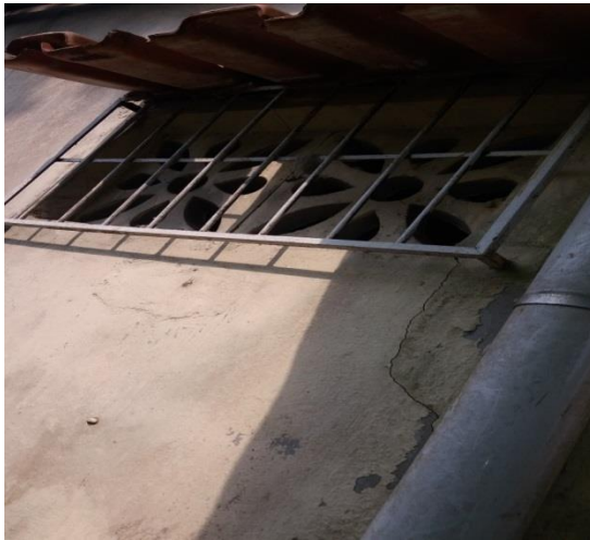
Imagem 11: Patologia 8 (PT8). Data do registro: 10/09/18. Fonte: Próprio autor.
