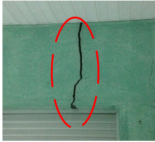
Imagem 10: Patologia 5 (PT5). Data do registro: 01/11/18. Fonte: Próprio autor.
