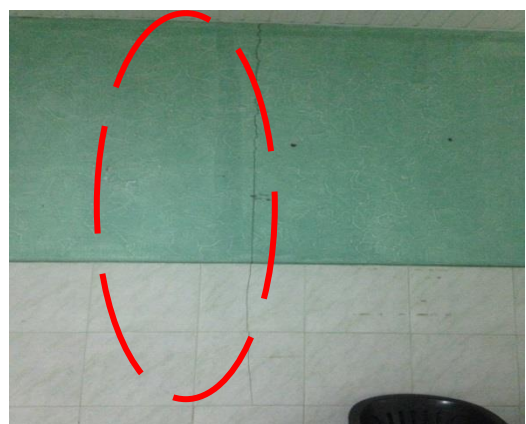
Imagem 2: Patologia 1 (PT1). Data do registro: 01/11/18. Fonte: Próprio autor.
