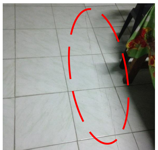
Imagem 6: Patologia 3 (PT3). Data do registro: 01/11/18. Fonte: Próprio autor.
