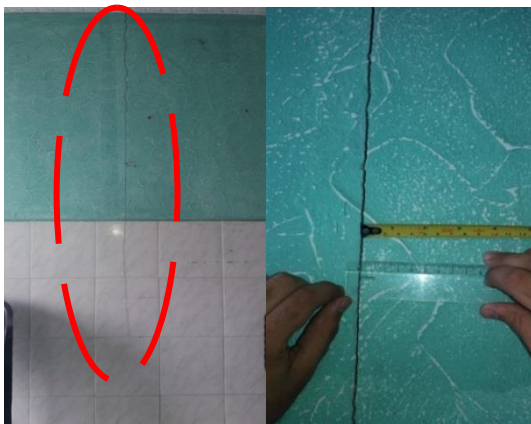
Imagem 1: Patologia 1 (PT1). Data do registro: 10/09/18. Fonte: Próprio autor.
