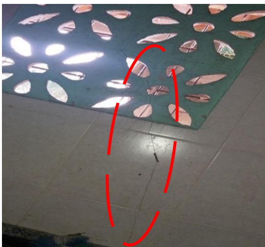
Imagem 13: Patologia 10 (PT10). Data do registro: 10/09/18. Fonte: Próprio autor.
