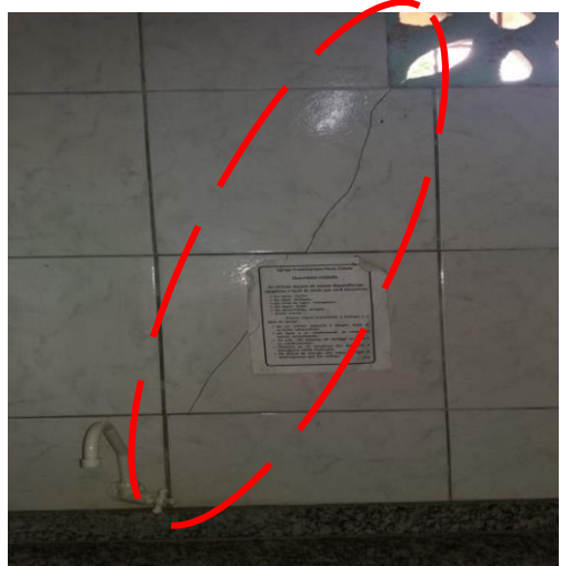
Imagem 12: Patologia 8 (PT8). Data do registro: 01/11/18. Fonte: Próprio autor.
