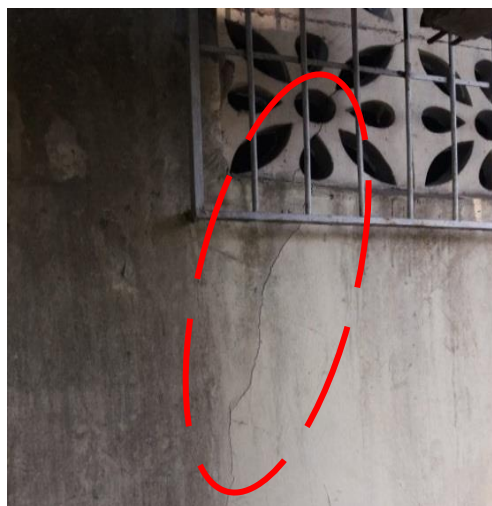
Imagem 14: Patologia 10 (PT10). Data do registro: 01/11/18. Fonte: Próprio autor.
