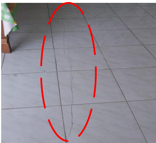
Imagem 5: Patologia 3 (PT3). Data do registro: 10/09/18. Fonte: Próprio autor.
