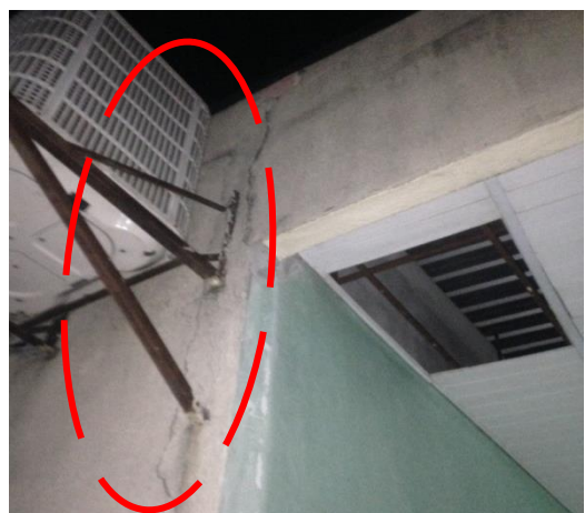
Imagem 4: Patologia 2 (PT2). Data do registro: 01/11/18. Fonte: Próprio autor.
