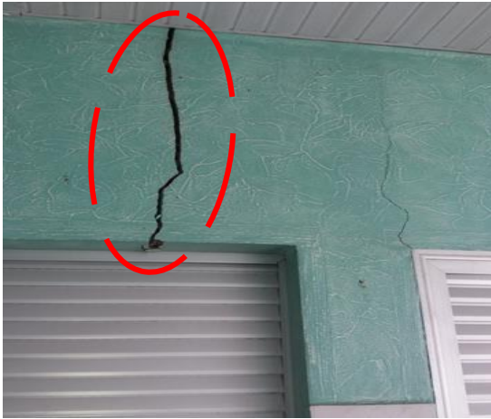
Imagem 9: Patologia 5 (PT5). Data do registro: 10/09/18. Fonte: Próprio autor.
