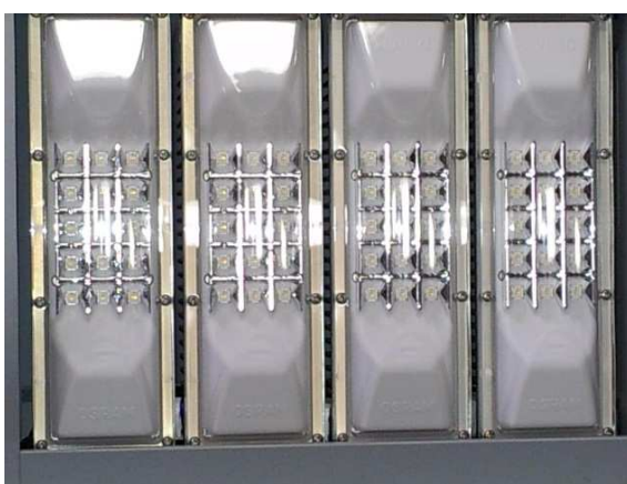
Figura 15 – Luminária LED – Formada por 4 módulos em paralelo. Fonte: Anglogold Ashanti, 2012.
