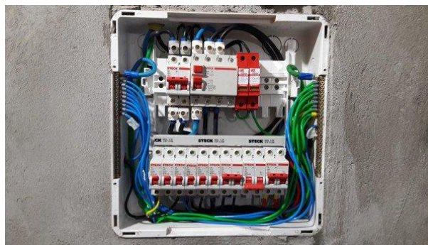
Figura 9: Quadro de distribuição. Fonte: Google
