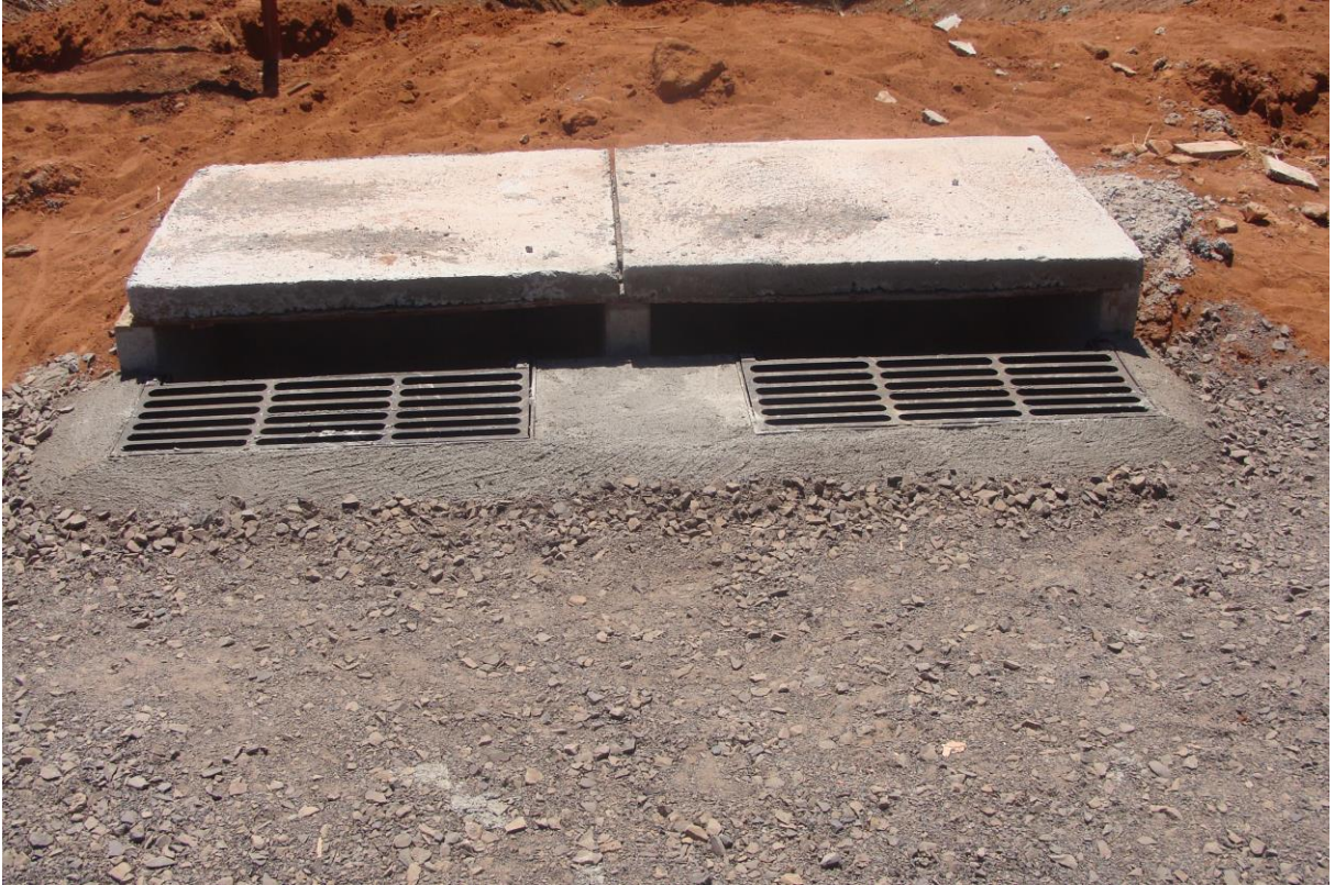
Figura 3. Boca de lobo com grelha
