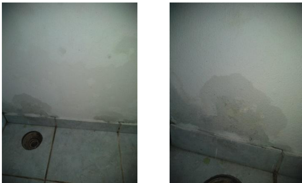
Figura 3 e 4: Manchas da área molhada.
