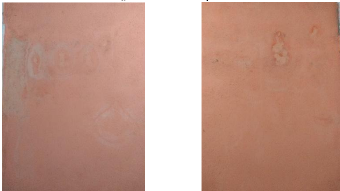
Figura 5 e 6: Manchas na parede
