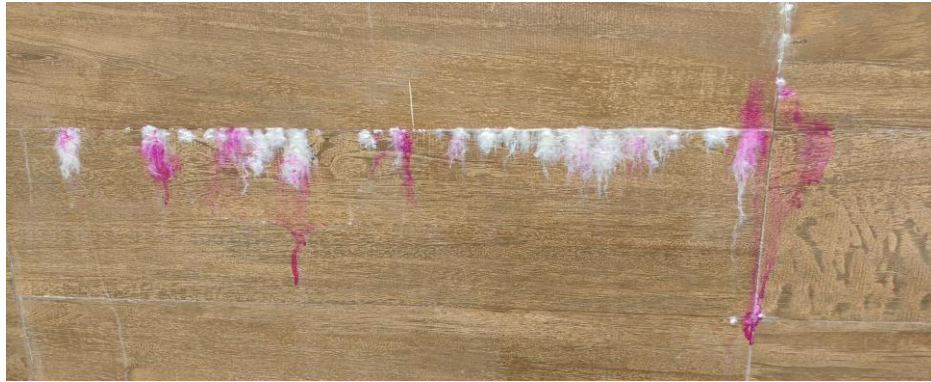
Figura 10 Aplicação de Fenolftaleína na Fachada
