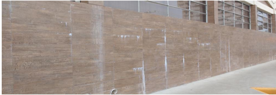
Figura 8 Situação atual da Fachada Mercado Monte Alto Fonte: autor André Fisnack 26/09/2018 Monte Alto SP.
