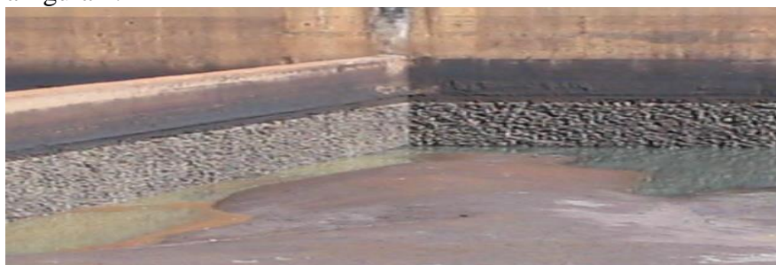
Figura 1 lixiviação devido à velocidade da água
