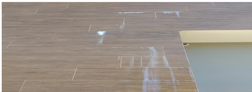
Figura 4 Eflorescência em revestimento
