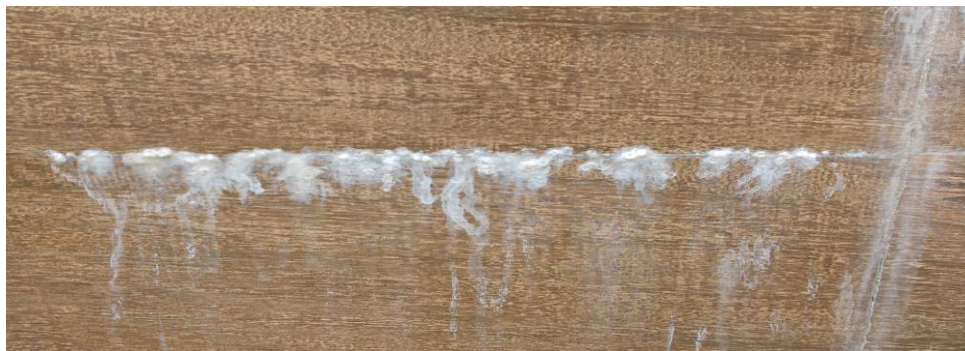
Figura 9 Situação atual da Fachada Mercado Monte Alto Fonte: autor André Fisnack 26/09/2018 Monte Alto SP.
