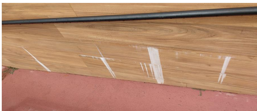
Figura 3 Figura 03- Eflorescência em revestimento Fonte: autoria própria 03/06/2018 Monte Alto SP
