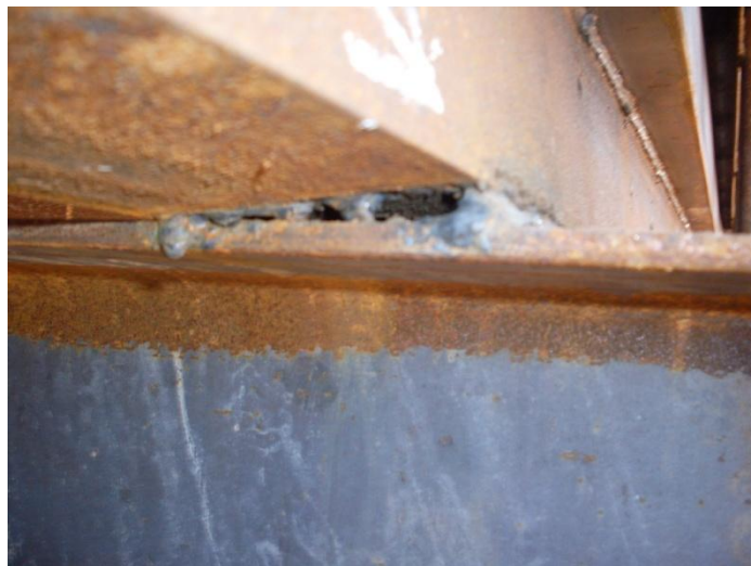
Fotografia 4 - Falta de penetração em junta de canto
