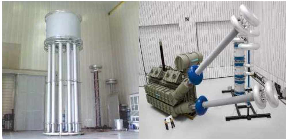
Figura 7 - Reator de alisamento e transformador
