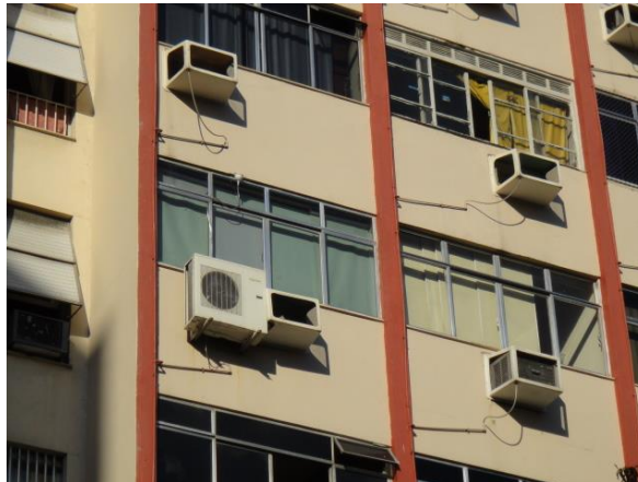
Figura 2 - Exemplo de máquinas de ar condicionado de difícil acesso
