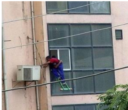
Figura 3 - Atividade de manutenção arriscada
