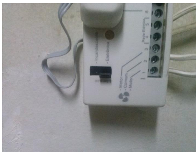
Figura 18 - Detalhe do Jumper na Central de Comando Ventilador
