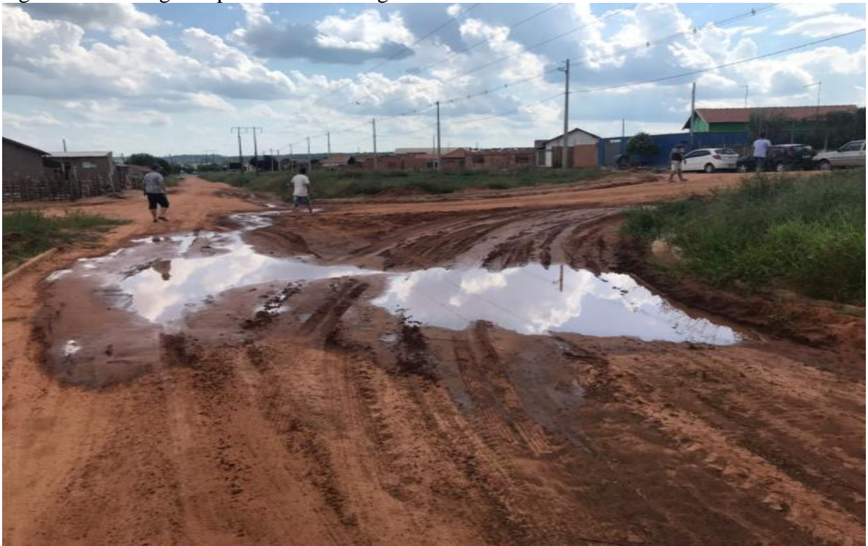
Figura 3: ruas alagadas por falta de drenagem.
