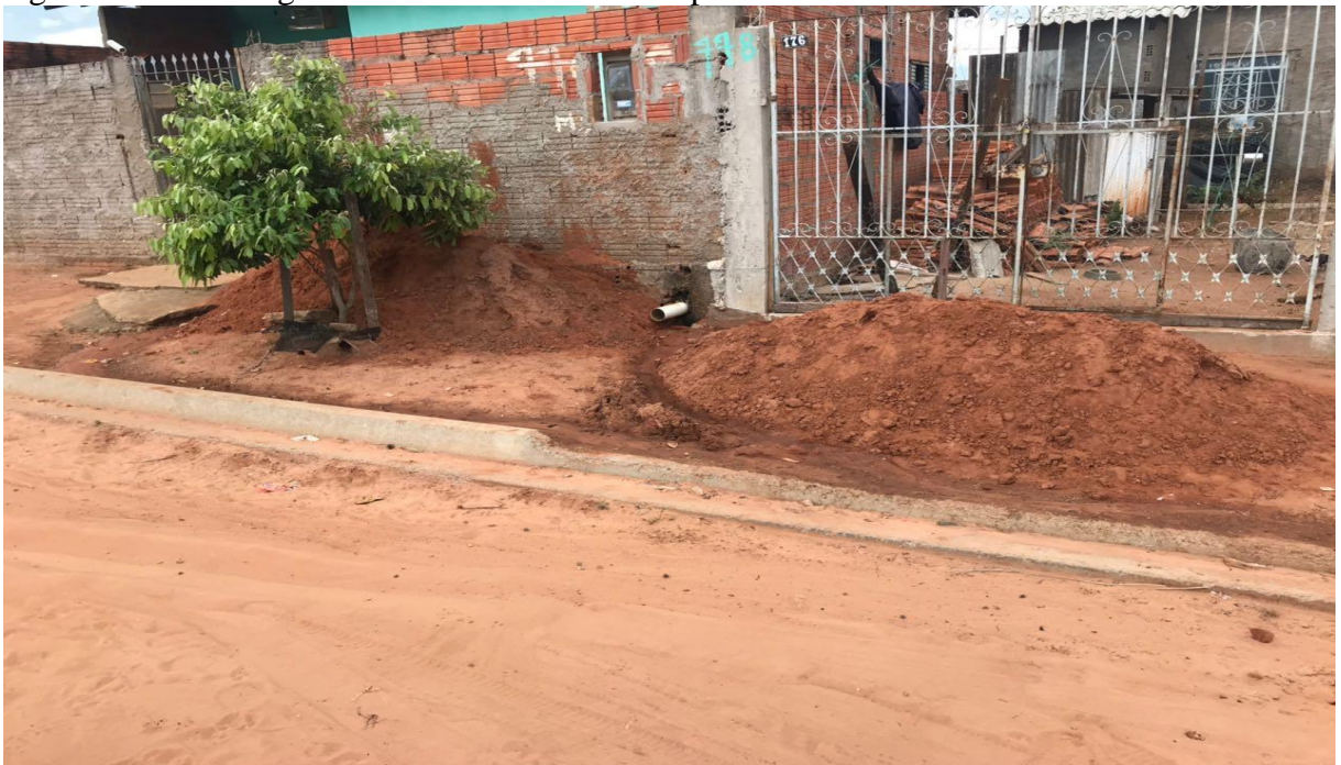
Figura 5: rede de esgoto sendo descartada na via pública.
