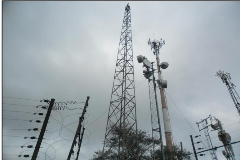
Foto 2 – Torres metálicas existentes na Estação de Barão de Cocais - MG
