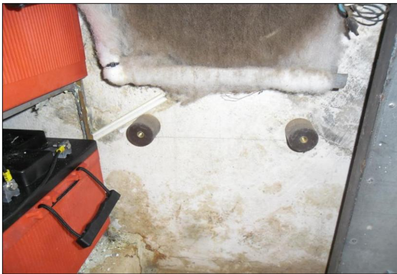
Foto 8 – Abrigo sem a barra ou caixa de equalização
