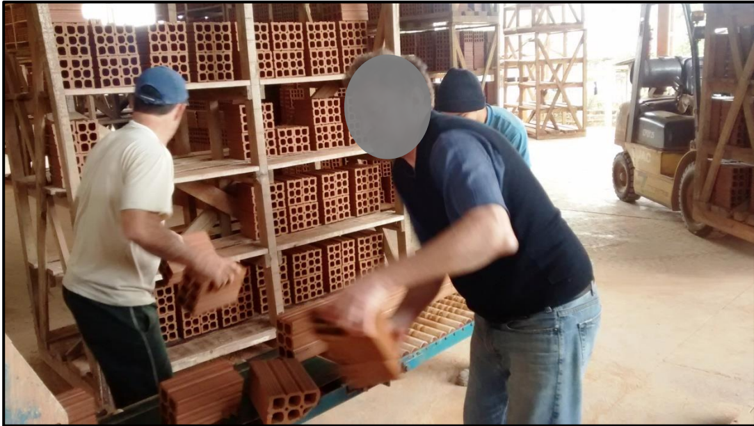
FIGURA 38 – Funcionário trabalhando sem uso de EPI's.
