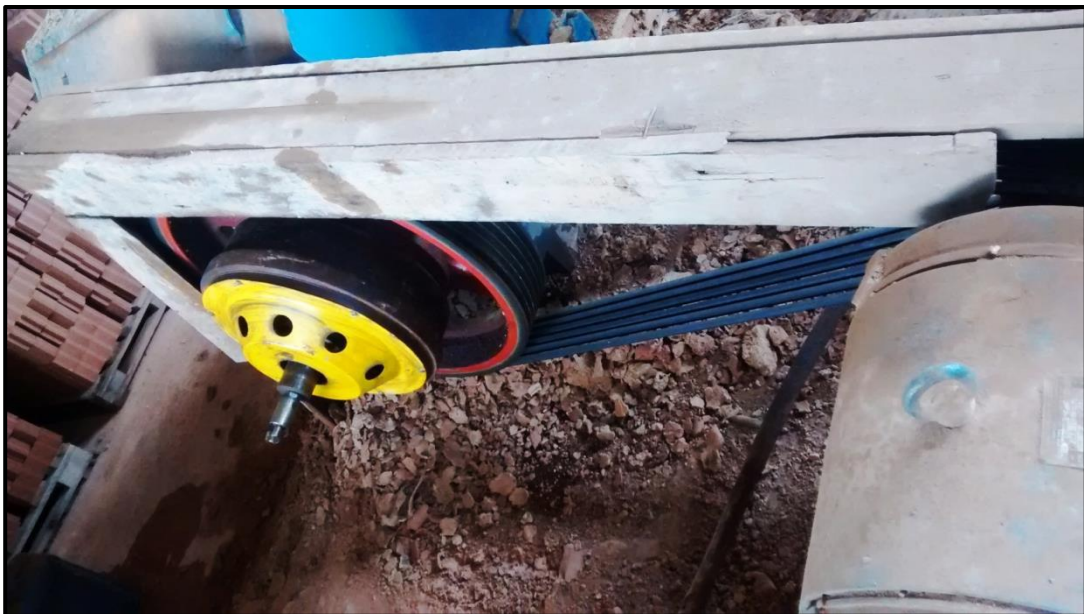
FIGURA 28 – Correia exposta com proteção improvisada. Fonte: Autor (2016).
