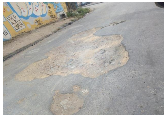
Figura 4: Trecho com escoriações e desgastes. Fonte: Próprio autor, 2018
