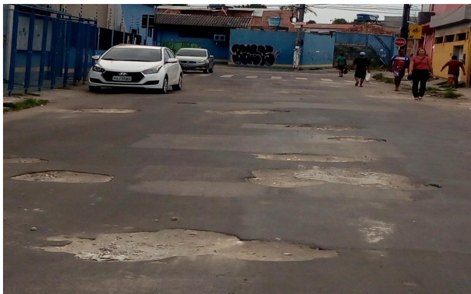
Figura 2: Trecho com escoriações e desgastes. Fonte: Próprio autor, 2018
