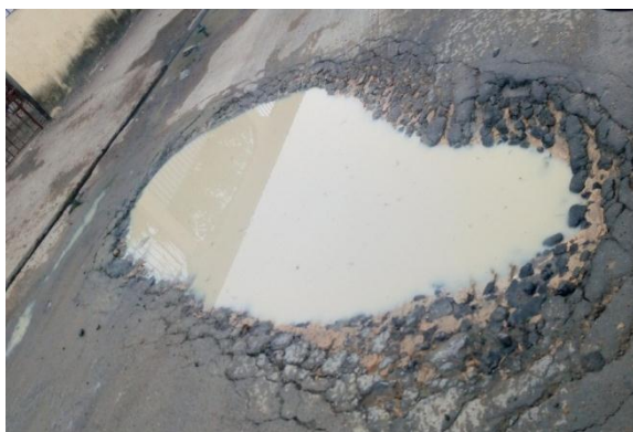
Figura 3: Trecho com escoriações e desgastes. Fonte: Próprio autor, 2018
