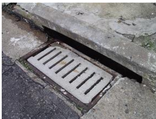
Figura 4 – Caixa de ralo e Boca de lobo simples http://www.ebanataw.com.br/drenagem/bocadelobo.htm
