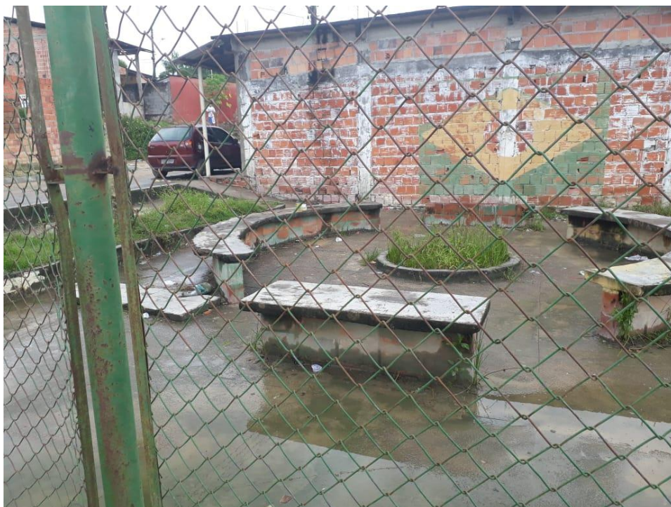
Figura 7: Situação atual das grades I.
