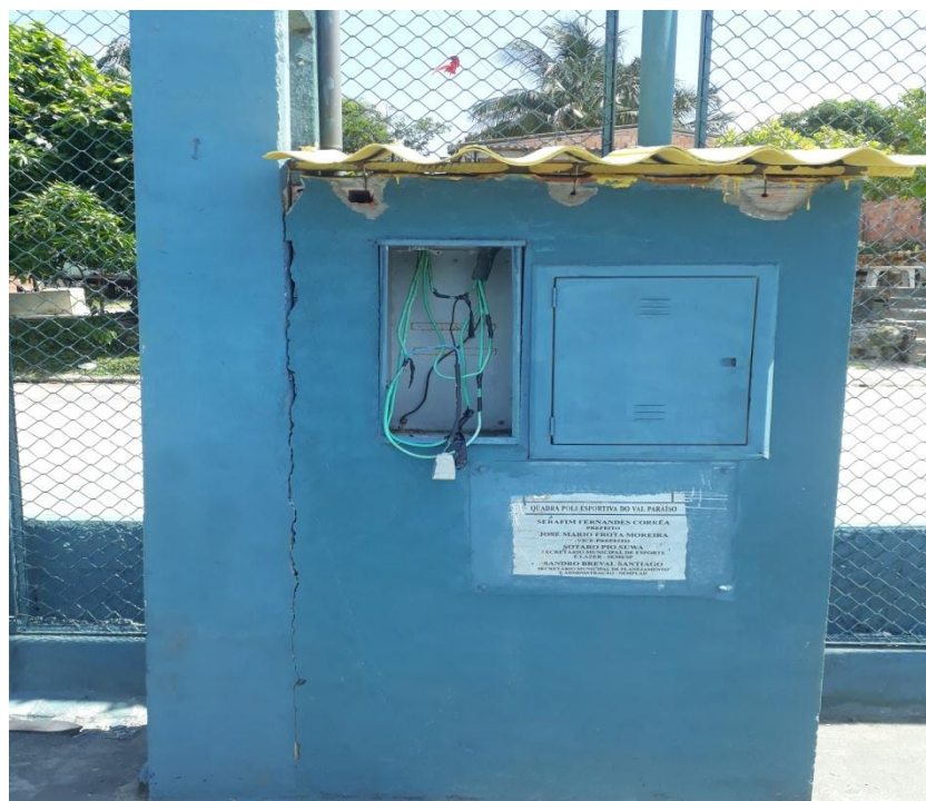
Figura 5. Situação do quadro de energia
