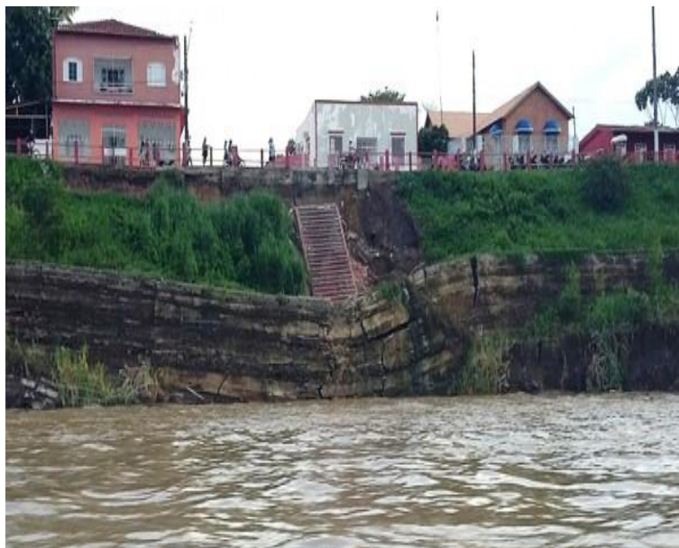
Figura 6: Deformação da estrutura de vido a ausência de sua base de apoio. Fonte: Jornal Repórter Parintins
